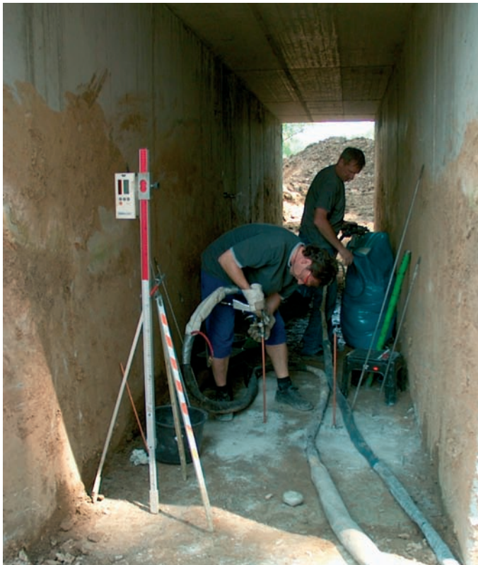
Vorne links im Bild: Der Laserempfänger, mit dem die Geradestellung des Silos millimetergenau überwacht wurde.
