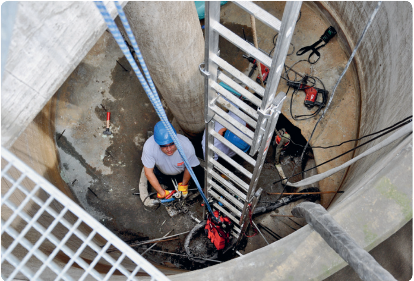
Das Setzen der Bohrlöcher, innerhalb des Mittelbauwerks, gestaltete sich aufgrund des Platzmangels und der dichten Bewehrung als knifflige Aufgabe.
