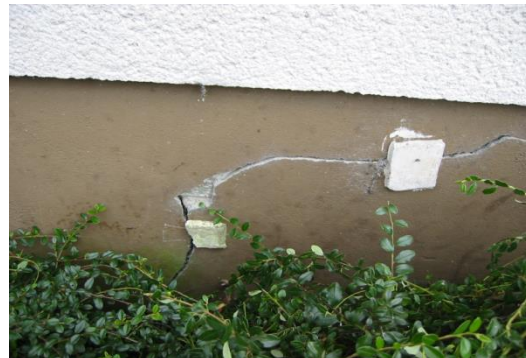
vom Untergrund abgelöste Gipsmarke
